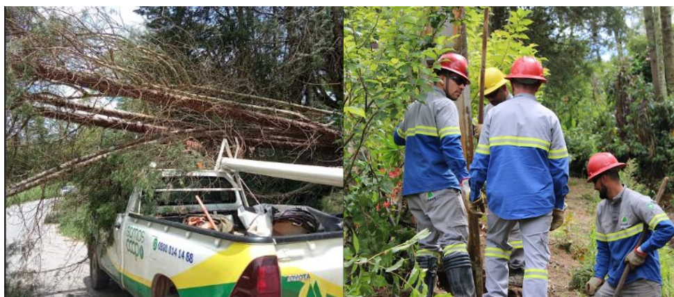
(Imagens da queda de árvores e a nossa equipe de técnicos de manutenção em campo)
